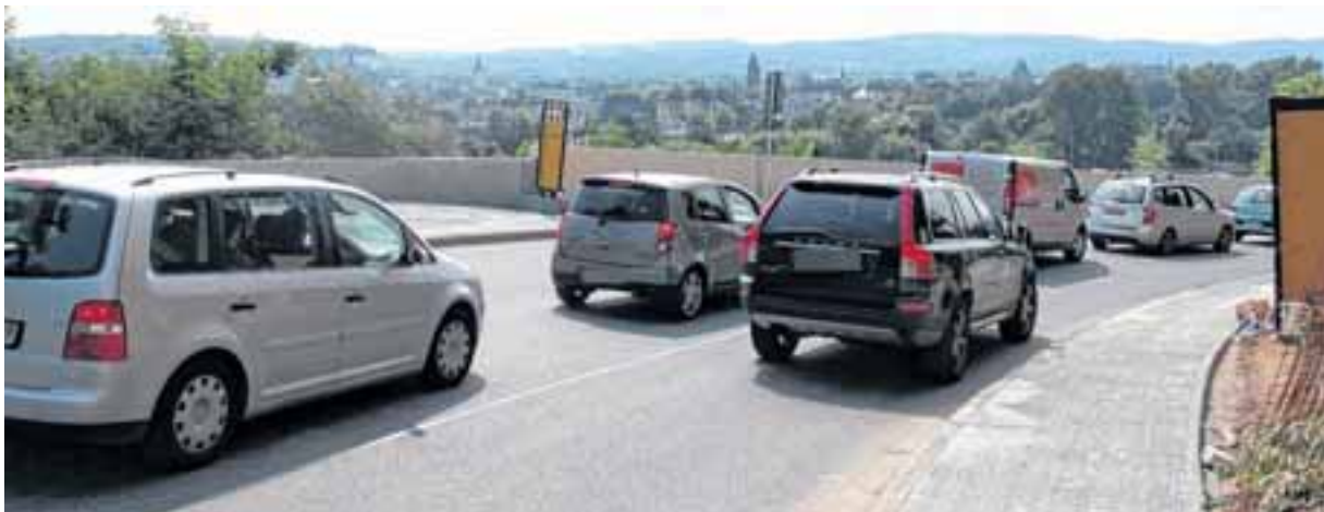
Zwei Spuren bergab: So soll der Verkehr auf der B 51 schneller fließen. Die Vollsperrung ist zwar seit Sonntag beendet, aber die Bauarbeiten laufen weiter. TV-FOTO: JÖRG PISTORIUS
